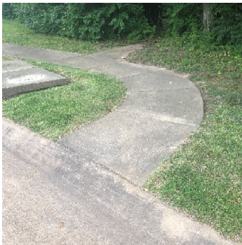
_____ No hay rampas en la acera (por ejemplo, acera de bajada de 6 pulgadas)
