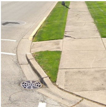
_____ Pendientes de rampas de bordillo (p. ej., exceso inclinación transversal)
